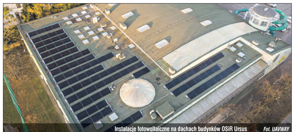
Instalacje fotowoltaiczne na dachach budynków OSiR Ursus Fot. UAWWAY
